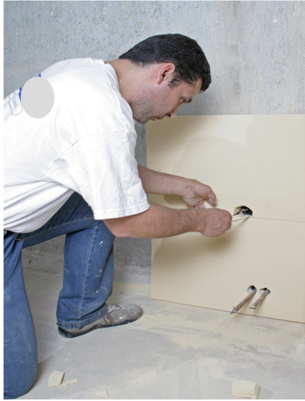
Receptacles /Pipes/ Conduits
